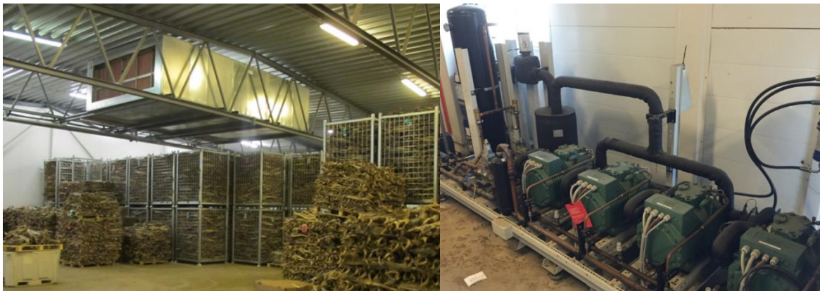
Figur 6 Klimalager med aggregat i tak (t.v.) og kompressor kulsesystem (t.h.)
